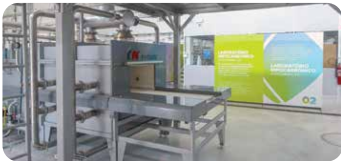
Forno híbrido contínuo de rolos instalado no Laboratório Hipocarbónico do CTCV.
